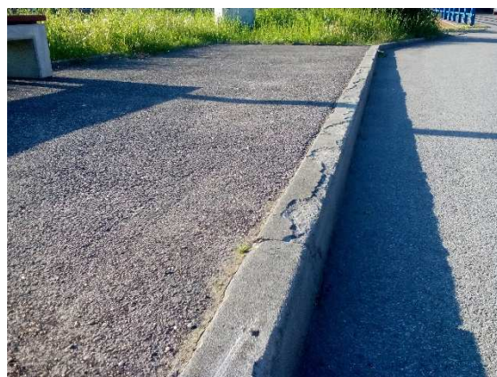
Obrázek 27: Poničený betonový silniční obrubník v zastávce Železný Brod, Poříčí
