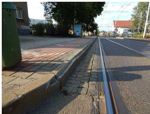
Obrázek 26: Improvizovaná úprava horní hrany nástupiště v zastávce Liberec, Dolní Hanychov
