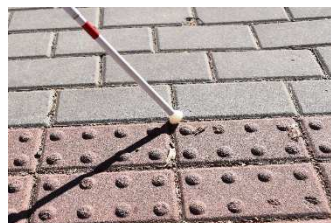
Obrázek 10: Nevhodná dlažba mimo signální pás se skosením, snižující kontrast. (NIPi)
